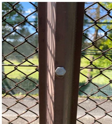
写真 2 亜鉛メッキボルト／塗装 支柱鋼との接触状況
