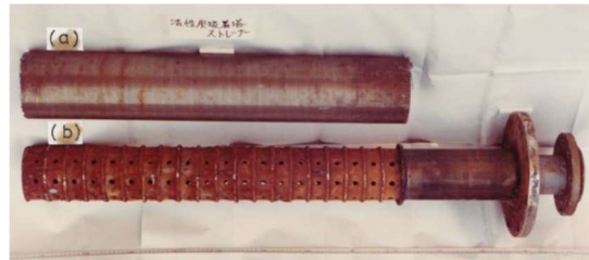
写真 1. ろ過ストレーナに発生した孔食
